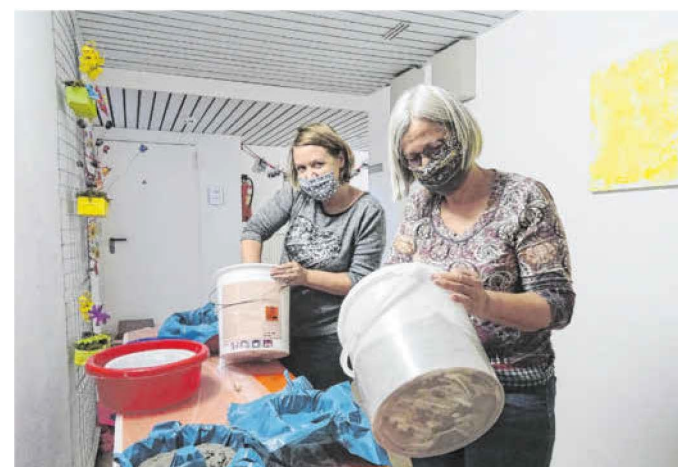
Die Frauen haben Spaß beim Betonieren – auch wenn sie einen Mundschutz tragen müssen.
